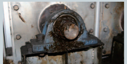
耐熱用ビローブロックに毎日給油を行い、6カ月に1度ユニットを交換。
